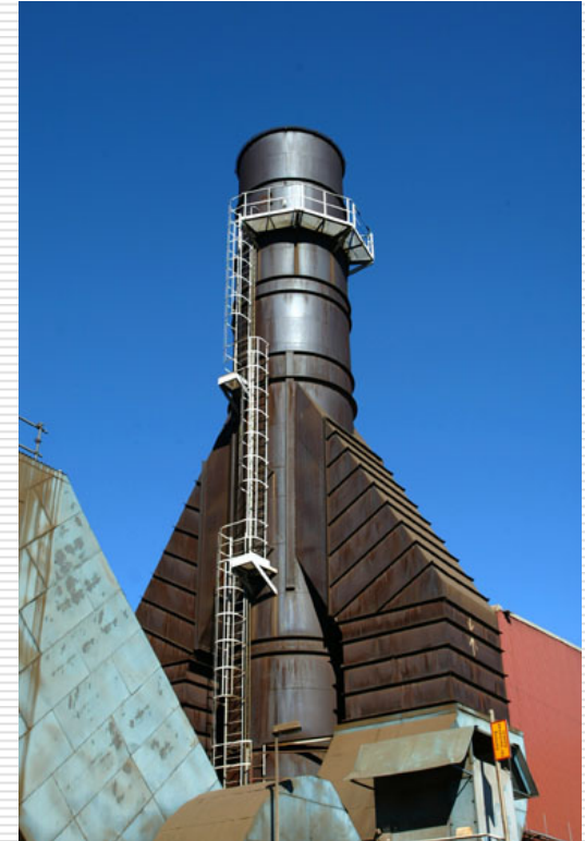
Utsugsfläktar med rökgasfilter vid Ijusbågsugn. Fundia Special Bar AB, Smedjebacken Foto: Stig-Göran Nilsson (2002)
